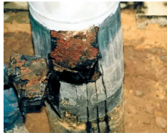
Bild 1: Umhüllungs- und Korrosionsschäden im Übergangsbereich Erde/Luft
