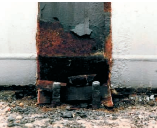
Bild 3: Sichtbare Korrosionsschäden nach der Demontage einer Rohrschelle Fig. 3: Visible corrosion damage following removal of a pipe clamp
