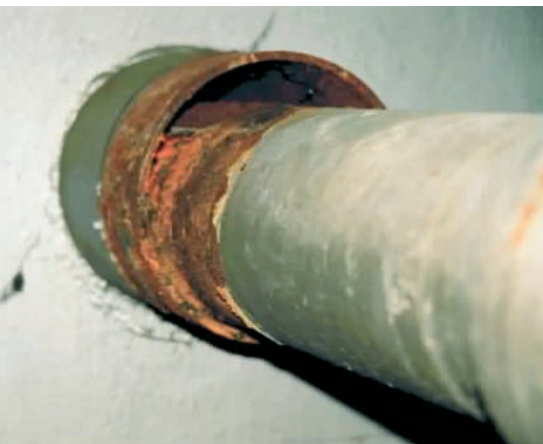
Bild 2: Korrosionsschäden im Bereich einer Rohrdurchführung Fig. 2: Corrosion damage at a pipe penetration
