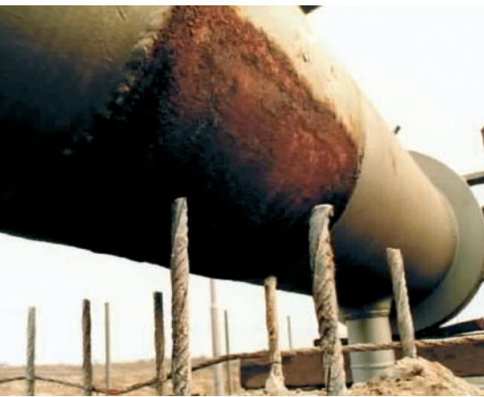
Bild 6: Korrosionsschäden nach der Demontage eines Rohrlagers
