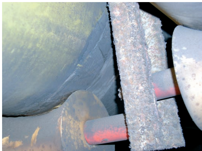
Bild 5: Korrosion im Bereich der Rollenlager durch mechanischen Verschleiß Fig. 5: Corrosion in the area of the roller-bearing by dint of mechanical erosion
