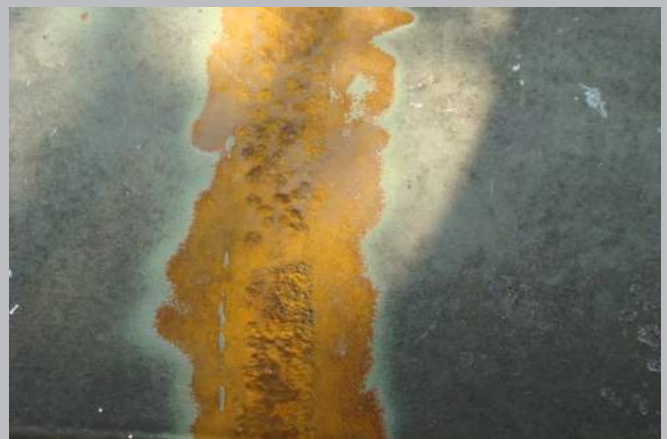
Bild 2: Exemplarisches Beispiel für Korrosionsschäden unter Rohrschellen
